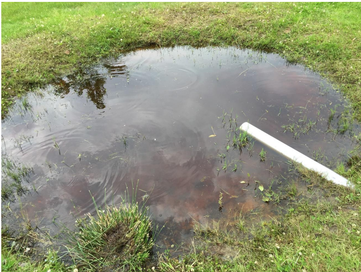
Figuur 19 juni 2016 grond en regenwater tot aan het maaiveld, geen verhuurbare situatie
